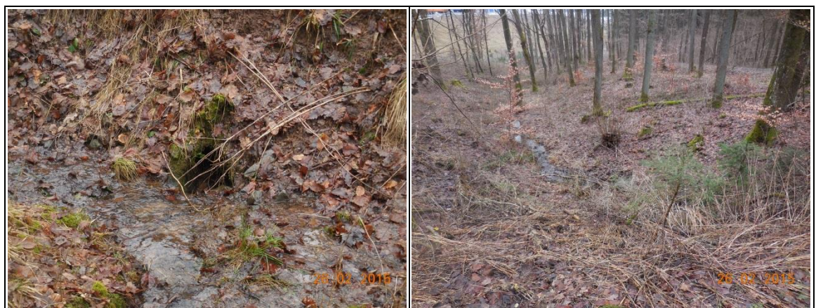
Abb. 29: Foto des künstlichen Durchlasses im Norden (links) und Pittenbachzufluss unterhalb des Durchlasses Richtung Werksgelände fließend (rechts).
