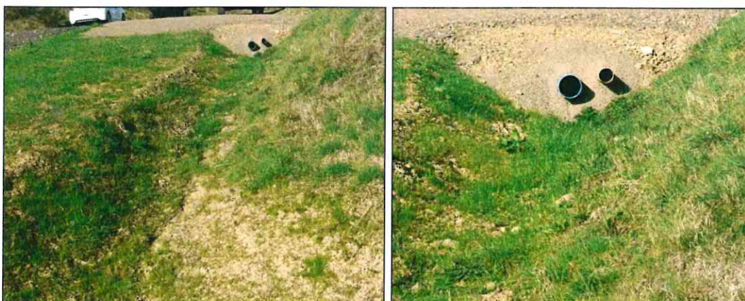
Abb. 9: Entwässerung in die bestehende Grünfläche mit Regenrückhaltefunktion, Foto: BGHplan, 04.04.2017.
